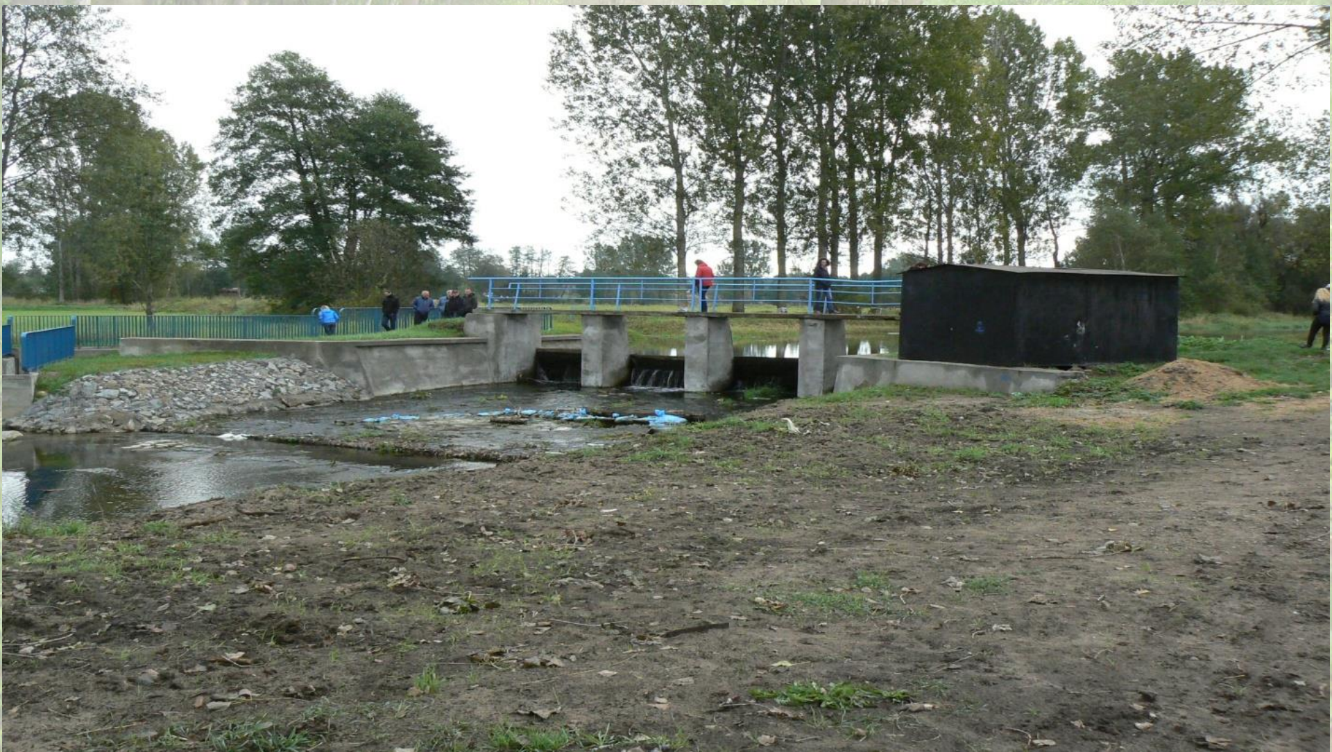
Jaz piętrzący na rzece Bełdówce w km 0727.
